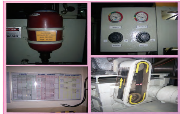
รูปที่ 8 การติดแกบลิชี้บ่งเป็น VCS ทิศทางการหมุนของสายพานและมาตรฐานแรงดันที่ใช้ว่าอยู่ที่เท่าไร
