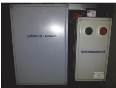
ภาพที่ 4 ชุดควบคุมมอเตอร์ไฟฟ้า
